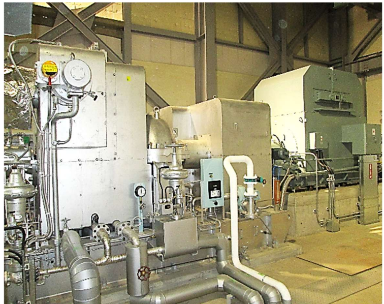
(蒸気タービン発電機)
